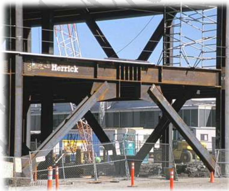
شکل ۶-۷ نمونه ای از قاب مهاربندی برون محور اجرا شده [12]
