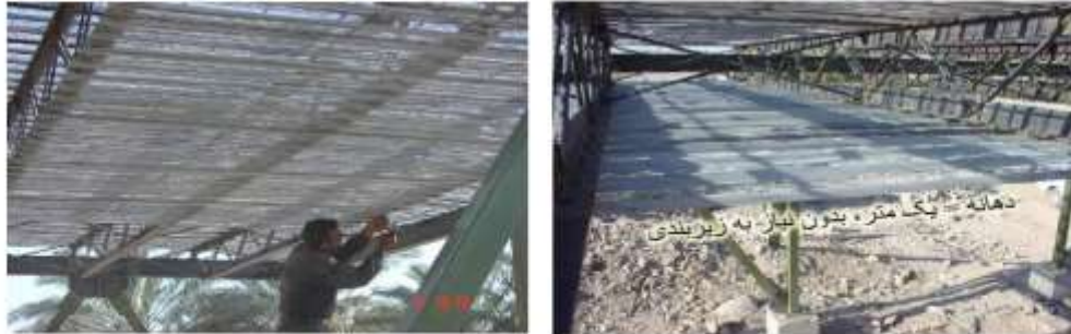
تصویر ۱۰ - اجرای سریع سقف کاذب سبک و یکپارچه با روفیکس، بدون نیاز به زیربندی تا دهانه یک متر
