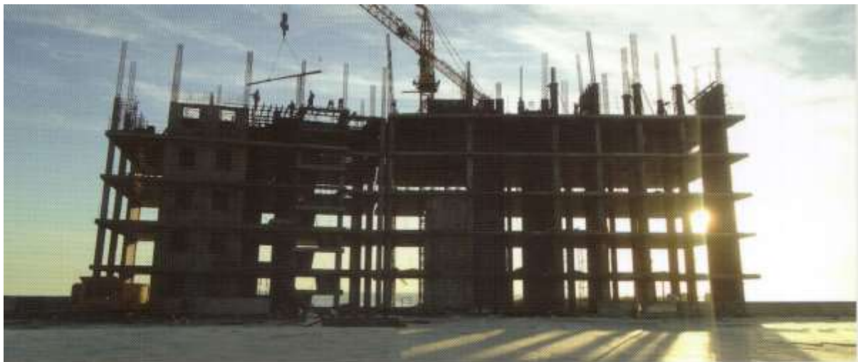
هتل و آپارتمان سیتی سنتر قشم محل پروژه: جزیره قشم بلندترین دهانه: ۷/۵ متر ضخامت دال: ۲۲ سانتی متر زیربنا: ۱۰۰۰۰۰ متر مربع
