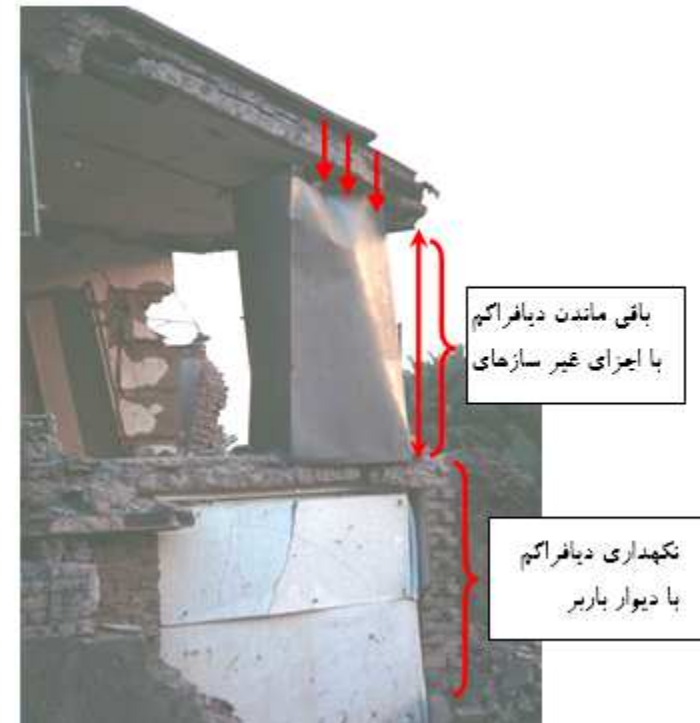
نقش اجزای غیر سازه‌ای در نگهداری دیافراگم سقف (بم)
