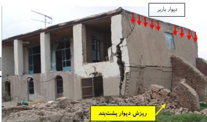
شکست خارج از صفحه-ی دیوار مرتفع به-علت عدم اتصال به سقف میانی
