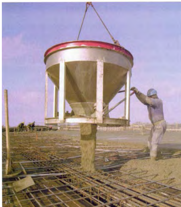
شکل ۳ انتقال بتن با جام و روش تخلیه آن (توجه شود که بتن، در نزدیکترین نقطه نسبت به بتن ریزی قبلی باید تخلیه می شود.)
