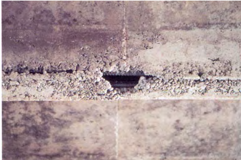
شکل ۸ نمونه‌ای از نحوه نامناسب تراکم بتن
