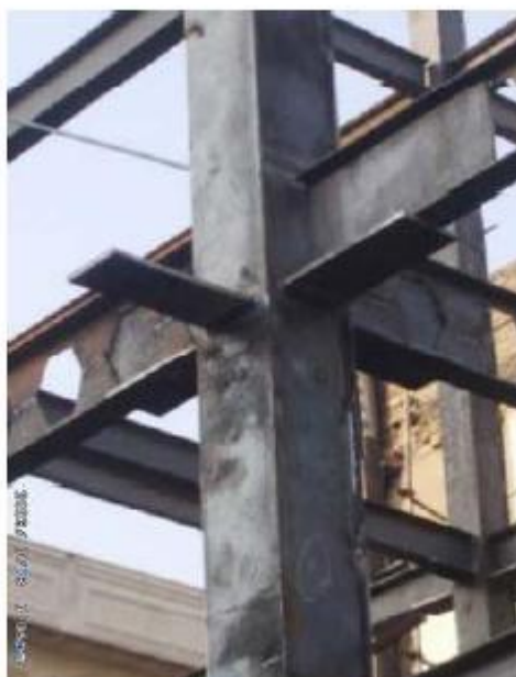
شکل ۵) جزئیات ضعف طول و کیفیت جوشکاری در یک ستون قوطی و اتصال گیردار تیر به ستون ساختمان فلزی.
