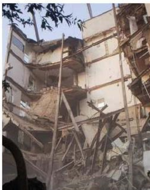
شکل ۳) ضعف جوشکاری اتصالات که یکی از علل اصلی تخریب یک ساختمان فلزی قدیمی در تهران بوده است.
